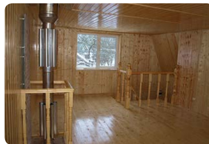
Дымоход с инверторами для отопления мансардного этажа
